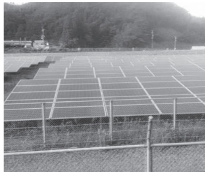
設置されたメガソーラー
